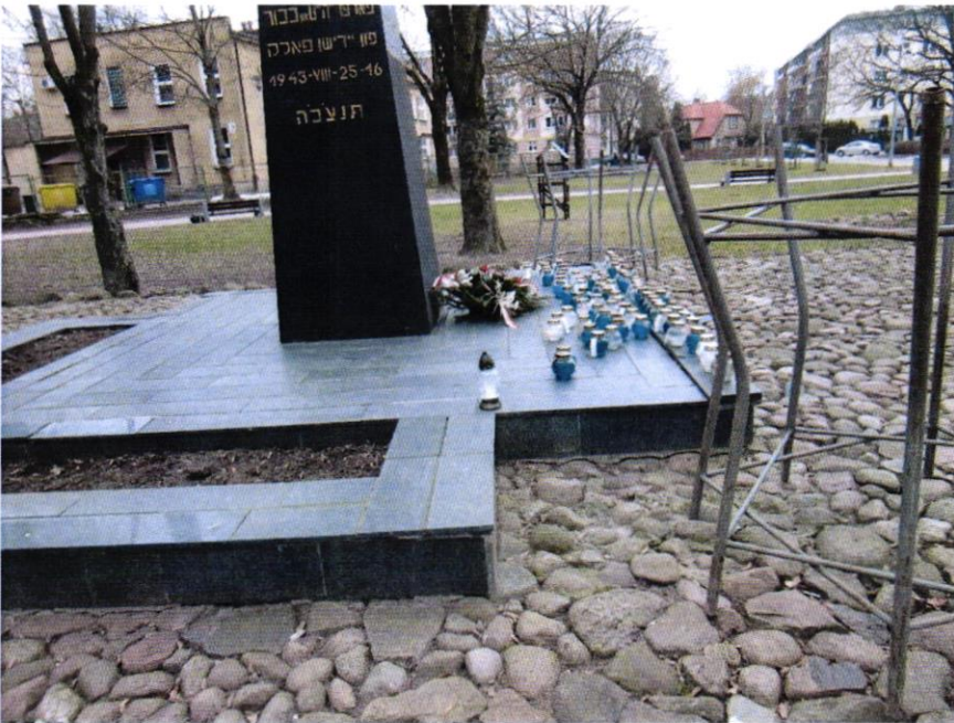
Foto. 6 Wykwity w dolnej części pomnika betonowego, przy płytach granitowych.
