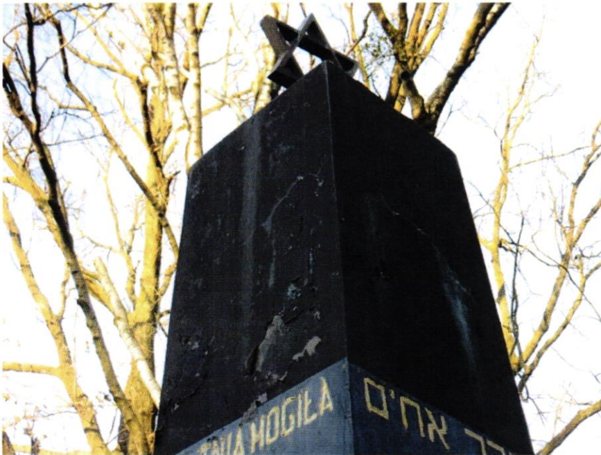
Foto. 8 Odstająca powłoka malarska od pomnika. Wycieki w górnej części pomnika.
