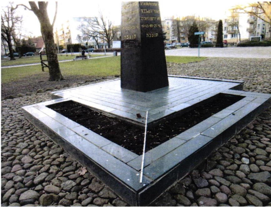
Foto. 7 Odstające płyty granitowe pionowe i poziome.
