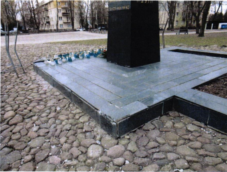
Foto. 3 Odstające płyty pionowe i poziome.
