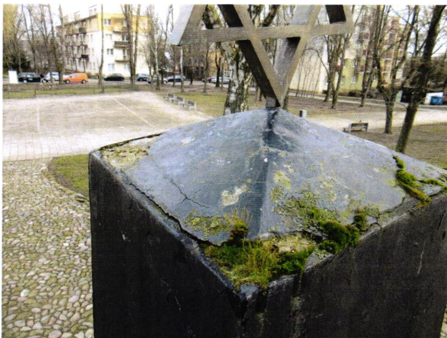
Foto . 9 Widok pomnika od góry. Ubytki powłoki zabezpieczającej pomnik od opadów atmosferycznych. Daleko posunięta korozja biologiczna.
