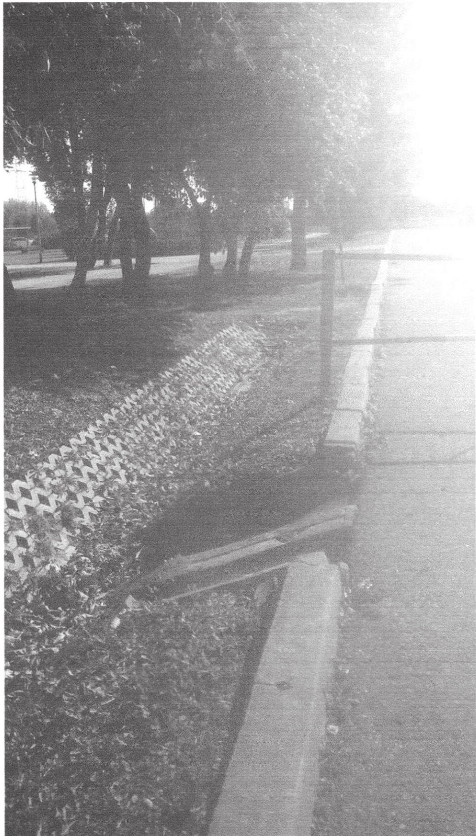
Fot.6. Ściek do z ul. Augustowskiej do rowu odpływowego
