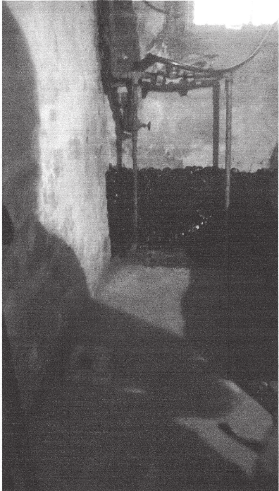
Fot.2. Piwnica domu nr 14 podtapiana wodami gruntowymi podczas intensywnych opadów atmosferycznych
