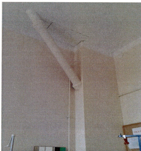
Rys. Nr 8 Źeliwne odpływy i piony w obudowie
